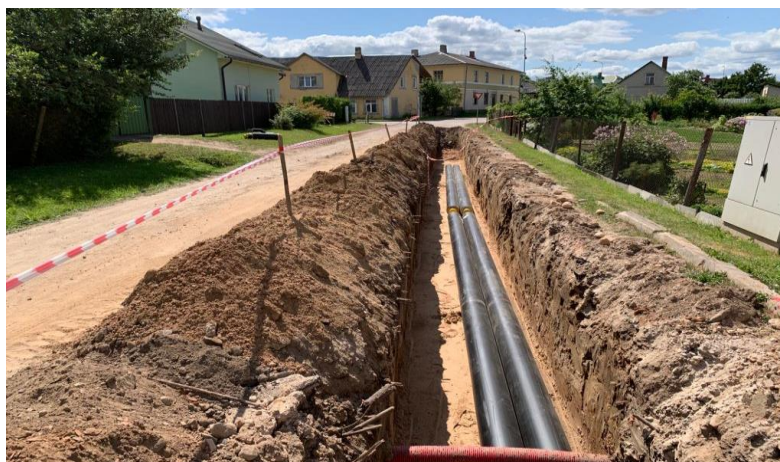
3.attēls. SIA "Alūksnes enerģija" organizatoriskā Būvniecības darbi objektā: "Siltumtrases un siltummezglu izbūve Siguldas, Pumpura un Lāčplēša ielā, Alūksnē", 2021.gads
