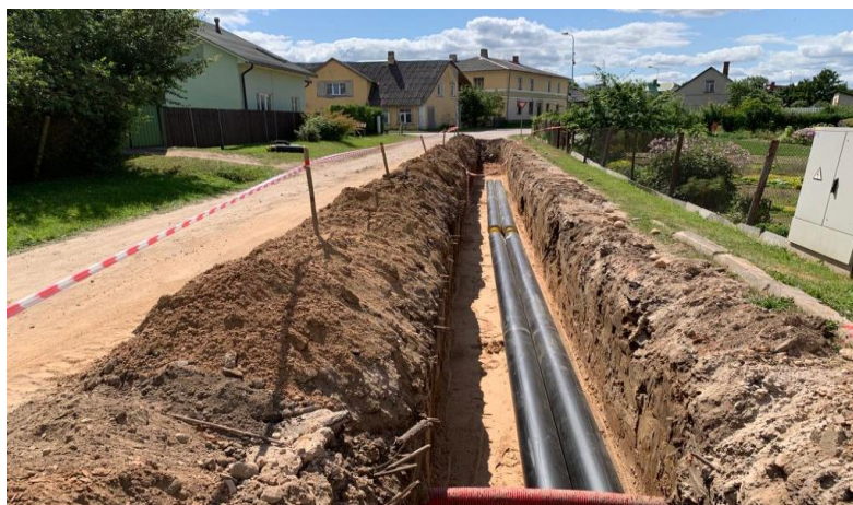
3.attēls. SIA “Alūksnes enerģija” organizatoriskā Būvniecības darbi objektā: “Siltumtrases un siltummezglu izbūve Siguldas, Pumpura un Lāčplēša ielā, Alūksnē”, 2021.gads
